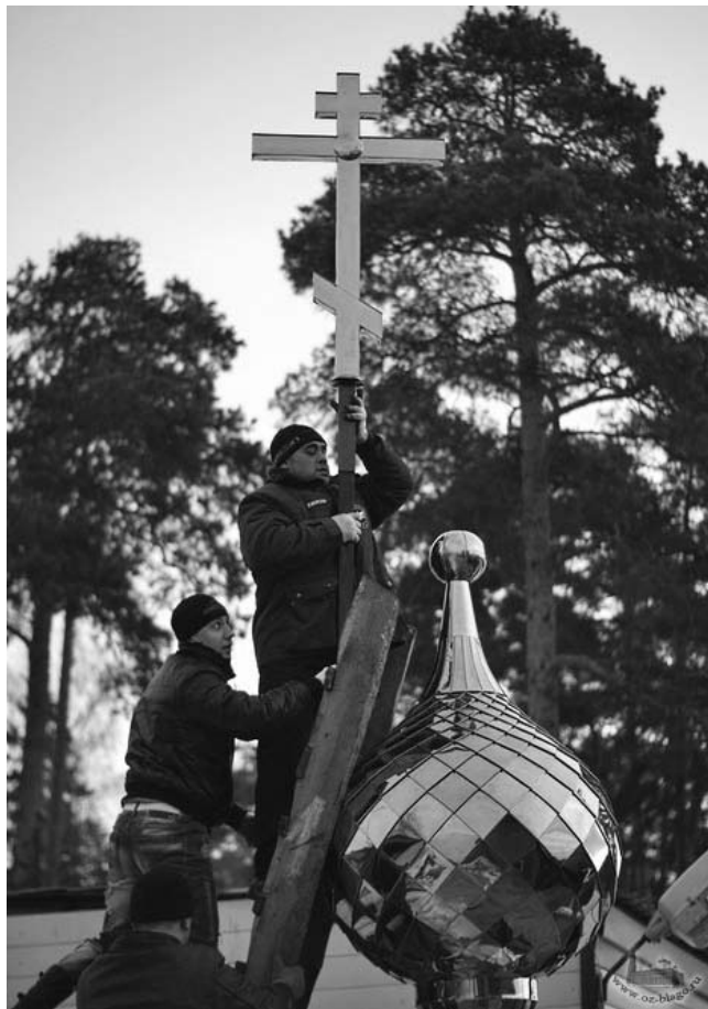
Последняя новость со строительства храмового комплекса: 29 декабря состоялся подъём купола на храм Петра и Февронии.
